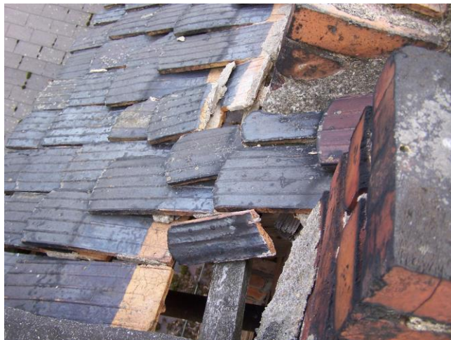
Vom Sturm abgerissene Dachziegel
